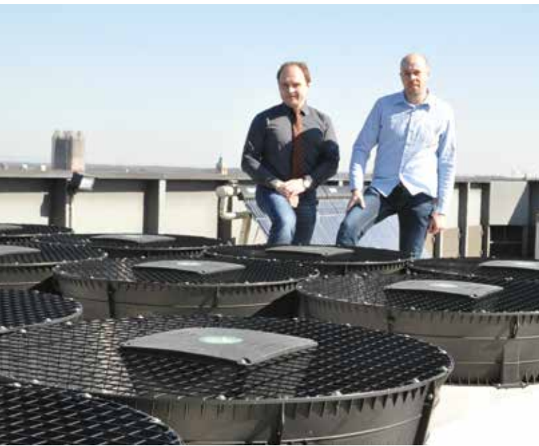
Energiemanager Bernhard Jünemann (li.) und Thomas Bucker inspizieren das neue Rückkühlwerk auf dem Dach der LBS.
